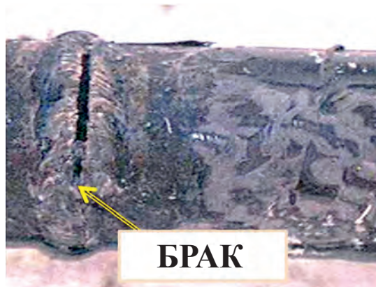
Рис.9. Авария на подземном распределительном газопроводе высокого давления в п. Пригородный Бийского района Алтайского края (01.03.2014 г.).
