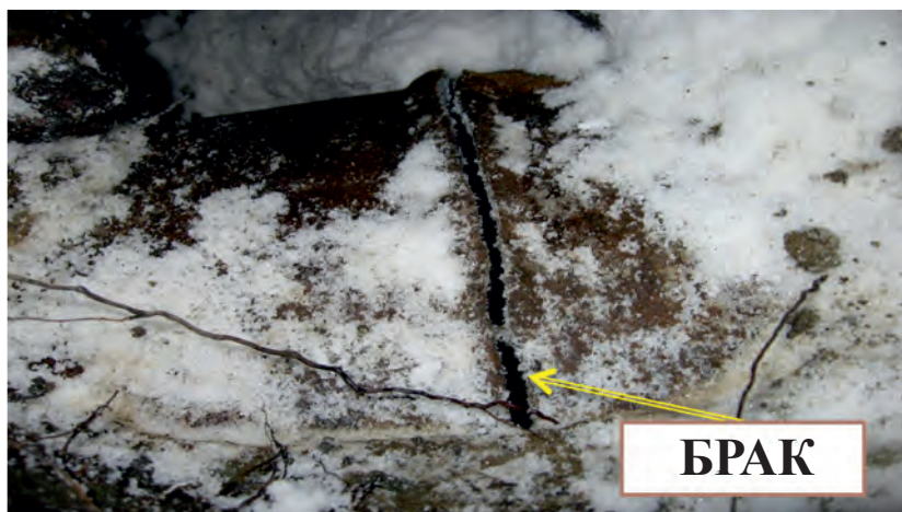
Рис.10. Авария на межплощадочном трубопроводе от насосной светлых нефтепродуктов до верхней резервуарной площадки нефтебазы (12.01.2015 г.).
