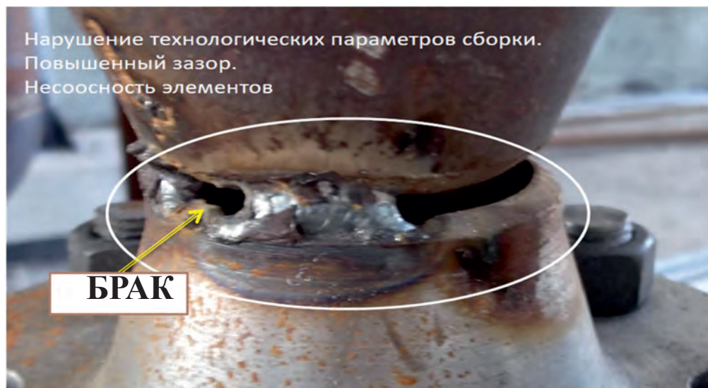
Рис. 13. Неправильная сборка сварного стыкового соединения.
