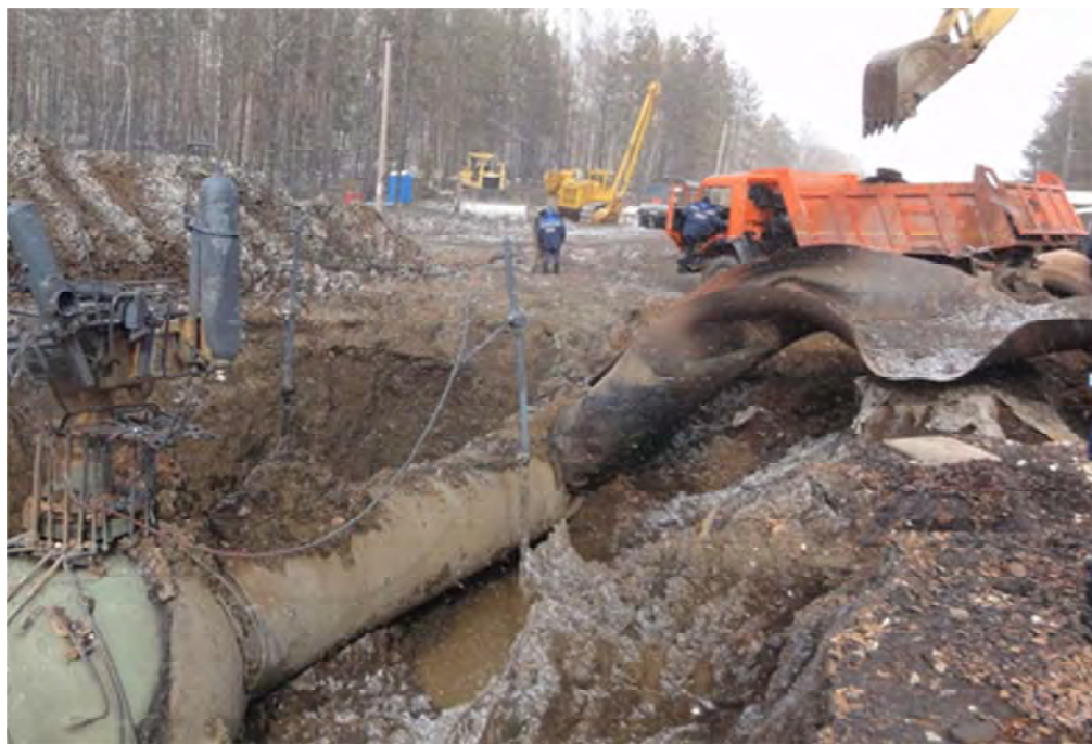
Рис.6. Авария на подземном распределительном газопроводе высокого давления в п. Пригородный Бийского района Алтайского края (01.03.2014 г.).
